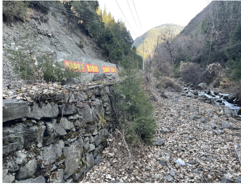
已建堤防老旧
