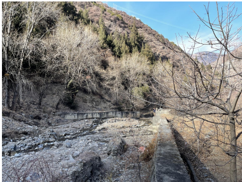
部分已建堤防已被冲毁
